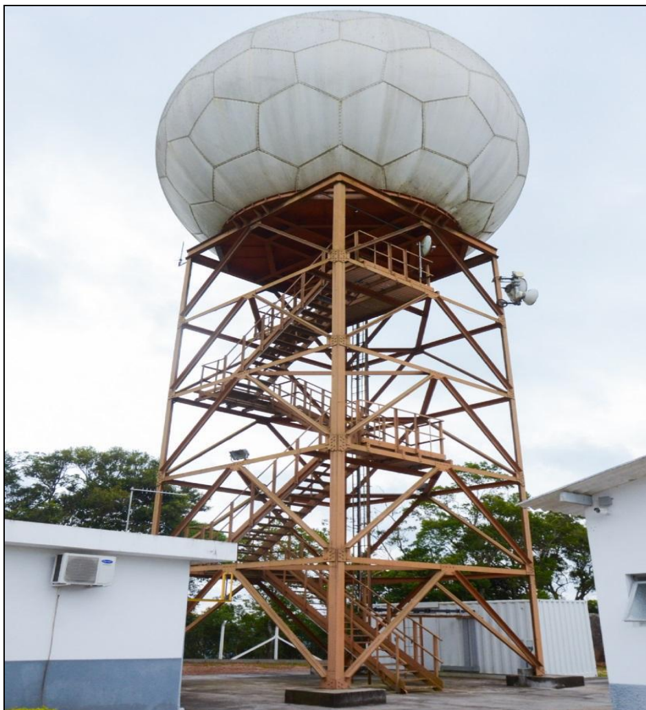
Imagem 28 – Radar Meteorológico instalado em Ponte Nova
