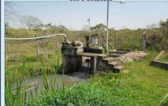
Captação de Água do Município (Set./12)
