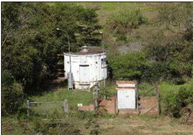
Figura 543. Vista parcial do ponto de captação de água do Ribeirão Baguaçu (Foto: Ago./13)
