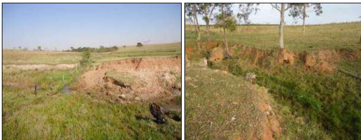
Figura 548. Processos erosivos ao longo do ribeirão Baguaçu. (Foto: Nov./12)
