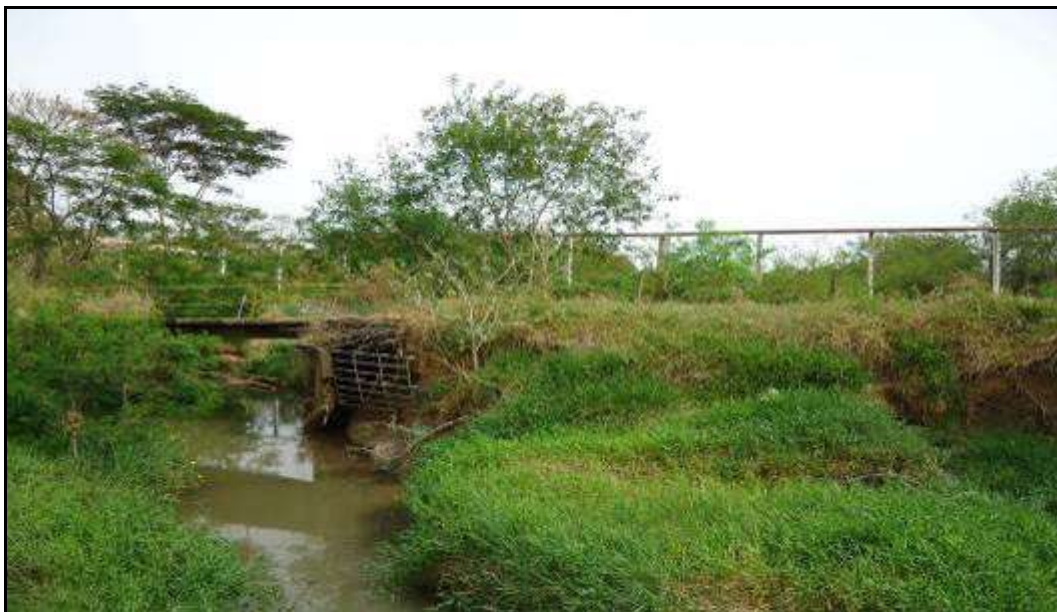
Figura 96. Processos erosivos ao longo das estradas rurais. (Foto: Ago.12)
